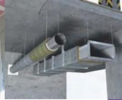
Ductos con resistencia al fuego
